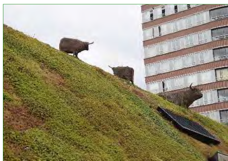
Begroeiing op dak parkeergarage.
